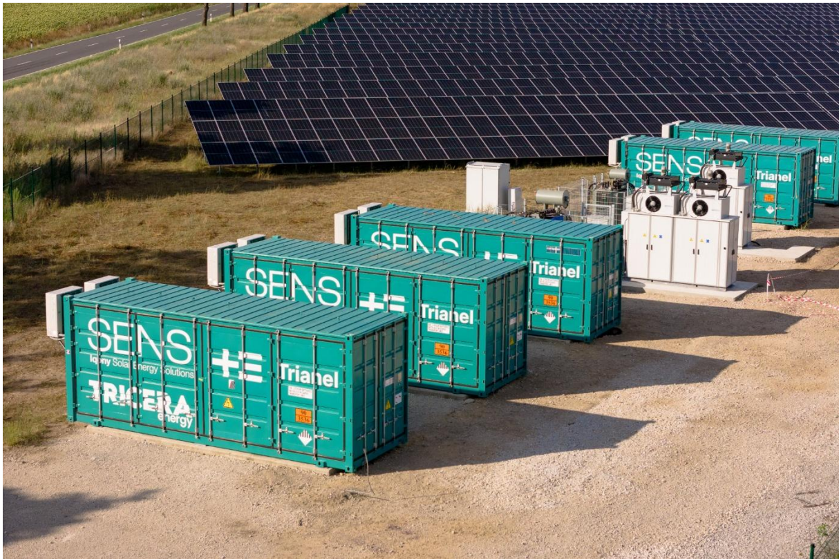
Bild: Batteriegrößspeichersystem der TRICERA energy aus Projekt mit Trianel in Lübars
