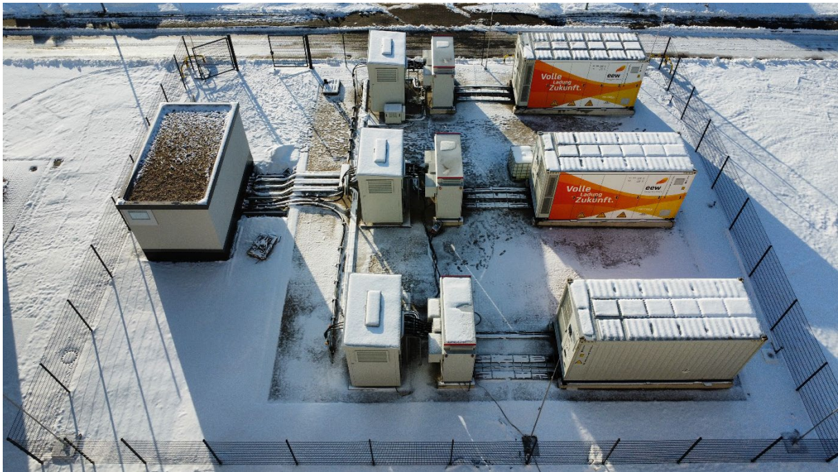
Bild: Drohnenbild des Batteriespeicher-Systems der TRICERA energy auf dem Gelände der EEW in Premnitz
