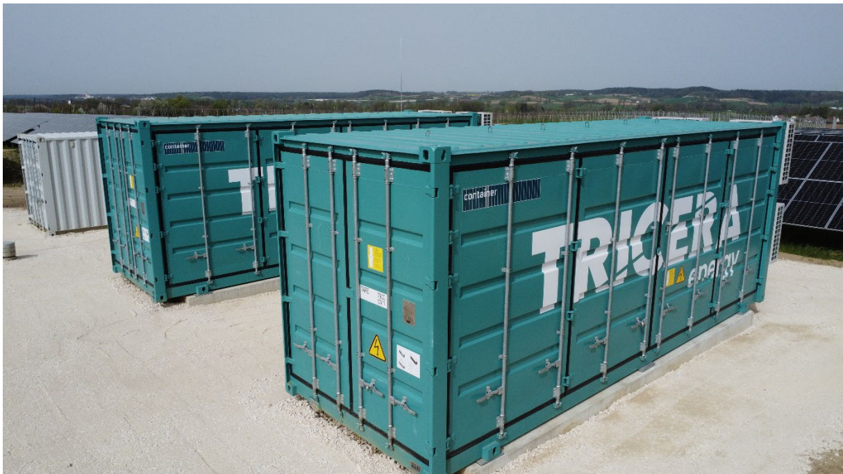
Bild: Symbolbild eines Batteriespeichers der TRICERA energy GmbH
